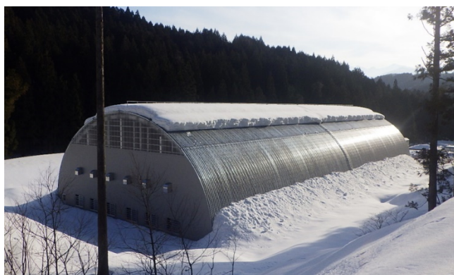
写真3.3 積雪深 60 cmにおける屋根積雪状況
